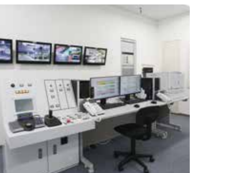
中央操作室 施設全体の処理ラインを管理します。機器の状態や処理の状況をテレビモニターなどで監視し、安全で効率の良い運転を行います。
