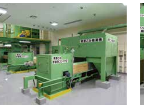
資源ごみ手選別コンベヤ 手作業により資源物と異物を選別します。
