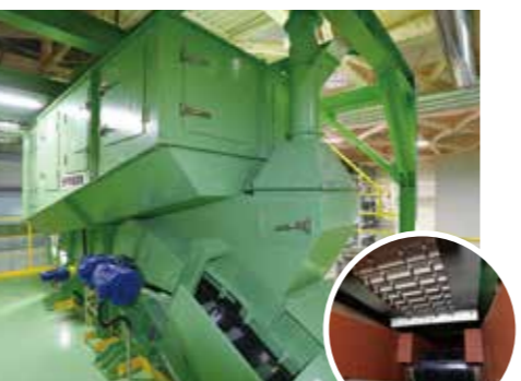
破砕物磁選機 電磁石を使って破砕ごみの中から鉄類を回収します。
