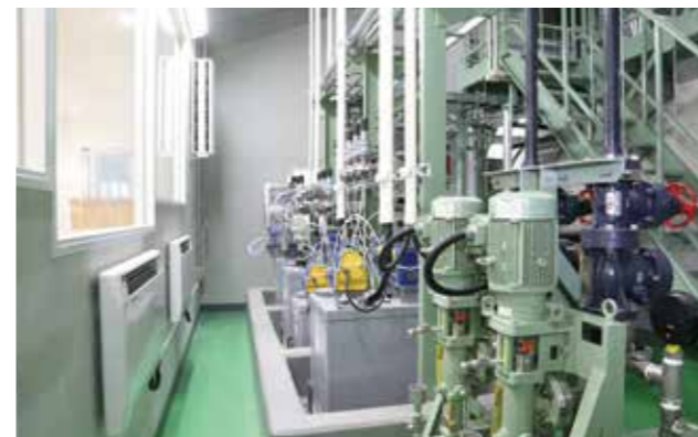
薬品注入設備
