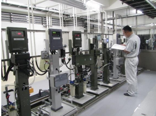
水質監視機器 濁度計、色度計、残塩計
