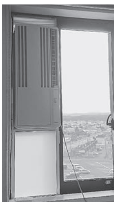
設置した窓用エアコン
