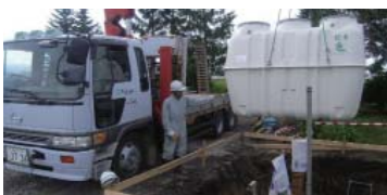
設置された合併処理浄化槽
