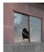
窓が割れた 管理不全空家
