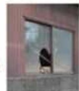
窓が割れた 管理不全空家
