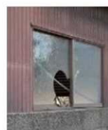
窓が割れた 管理不全空家
