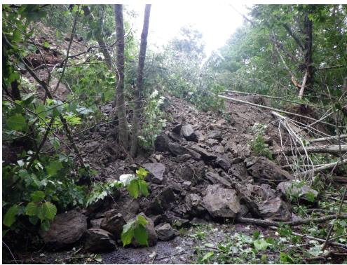
8月の大雨による被害状況(朝日岩尾内道路)
