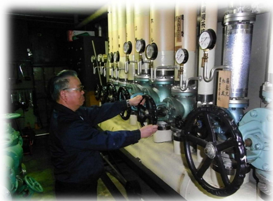
現在の集中暖房方式は、効率が悪く、 老朽化が目立ちます。
