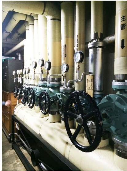
効率の悪い設備機器
