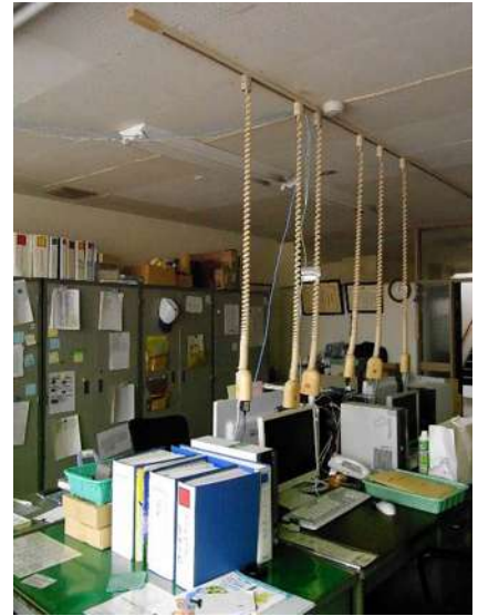
視線を遮る天井からの配線
