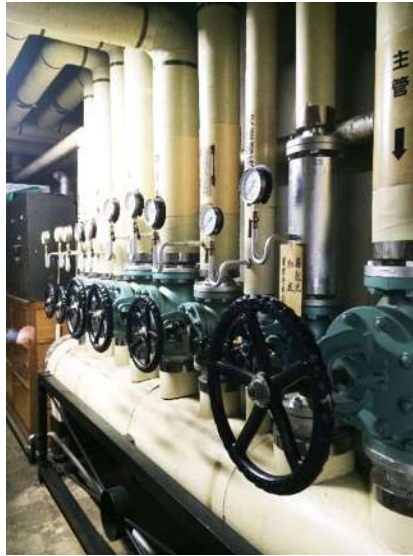
効率の悪い設備機器
