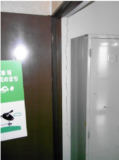
各所にみられる壁面のひび
