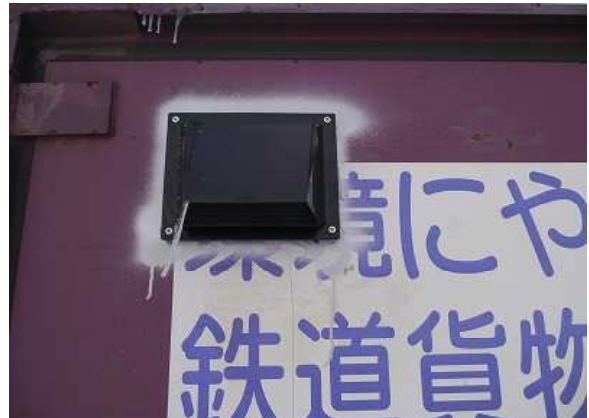
㉑ 農薬保管庫に整備した換気口
