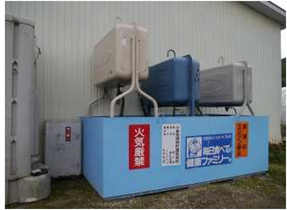
⑥防油堤を設置した燃料タンク
