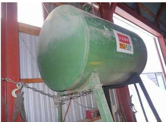
⑤転倒防止対策を行った燃料タンク
