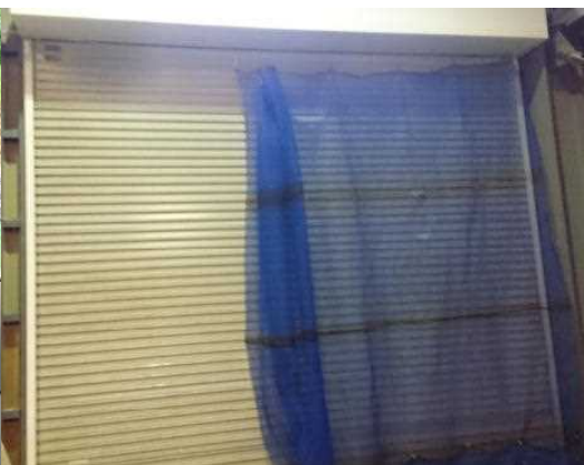
写真2 乾燥施設に設置した防鳥ネット
